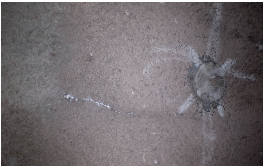
Figur 62: Bild/foto taget med systemkamera. Naturlig kalkfylld och öppen spricka.
