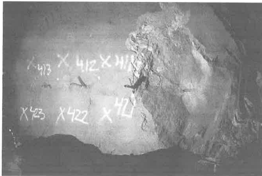
Figur 4.18: Återstående sprutbetong samt krater vid försöksområde 4. Remaining shotcrete and crater formed after test 4.
