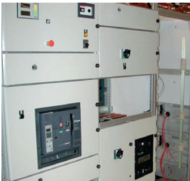
Figur 20. Exempel på teknikutrymme med elinstallationer.
