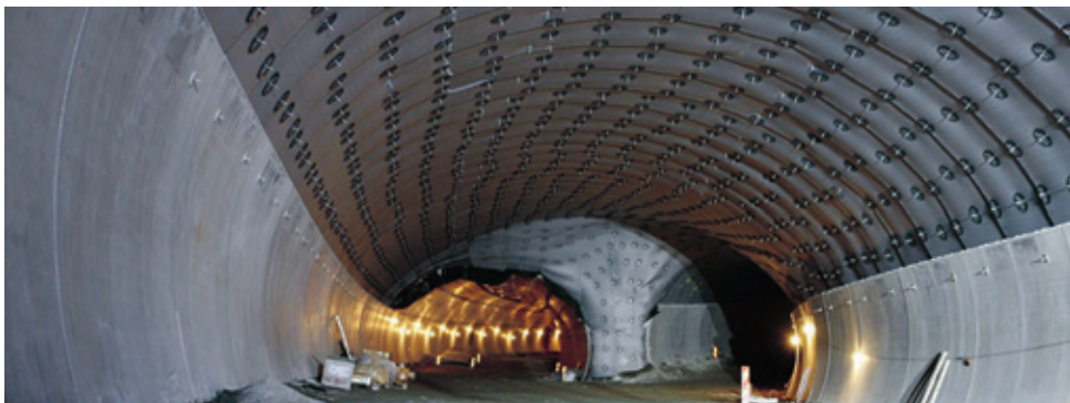
Figur 6. Väggelement och PE-skum i tak och anfang. PE-skummet täcks med brandskyddande sprutbetong.
