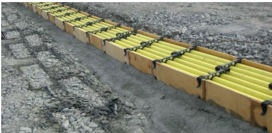
Figur 19. Exempel på kanalisation med OPI systemet. Paketet gjuts igen i ett senare skede.
