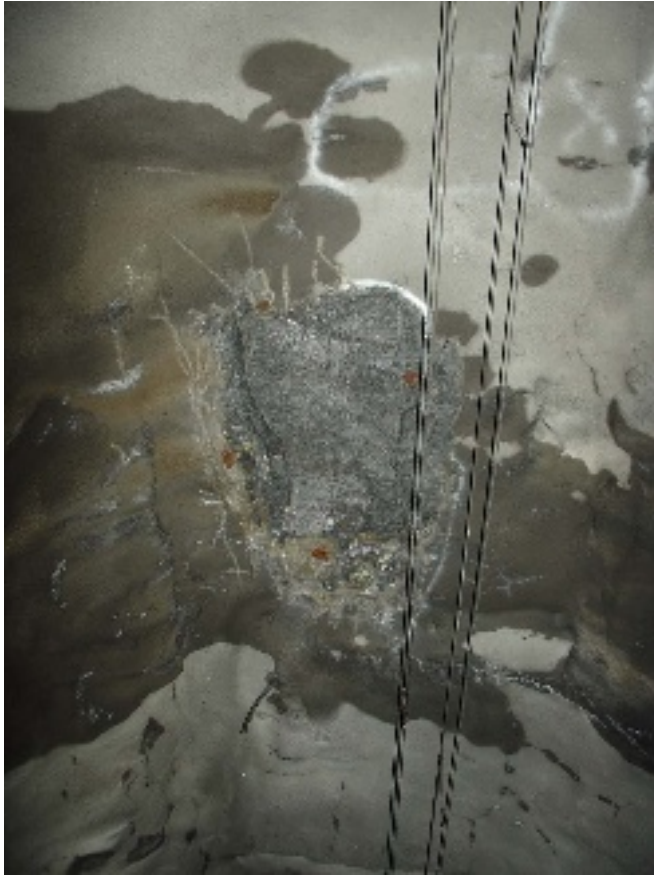
Figur 2.3.1.1 Område i taket där sprutbetong har fallit ned på spåret sannolikt orsakat av frostsprängning. Glödbergstunneln (Andrén 2006).
