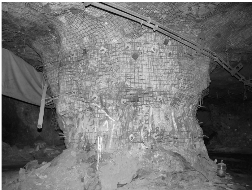
Figur 6.3. Typisk ”post pillar”, förstärkt med nät och bultar.
