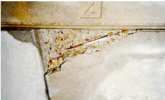
Bild 6.3-1. Skada på prefabricerat betongelement [23].
