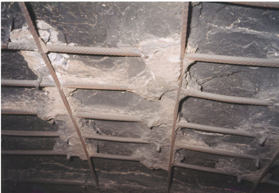
Bild 6.4-1. Kanaltunneln. Bild av tunneltak efter brand. [ http://cist.mit.edu/projects/fire.htm ]
