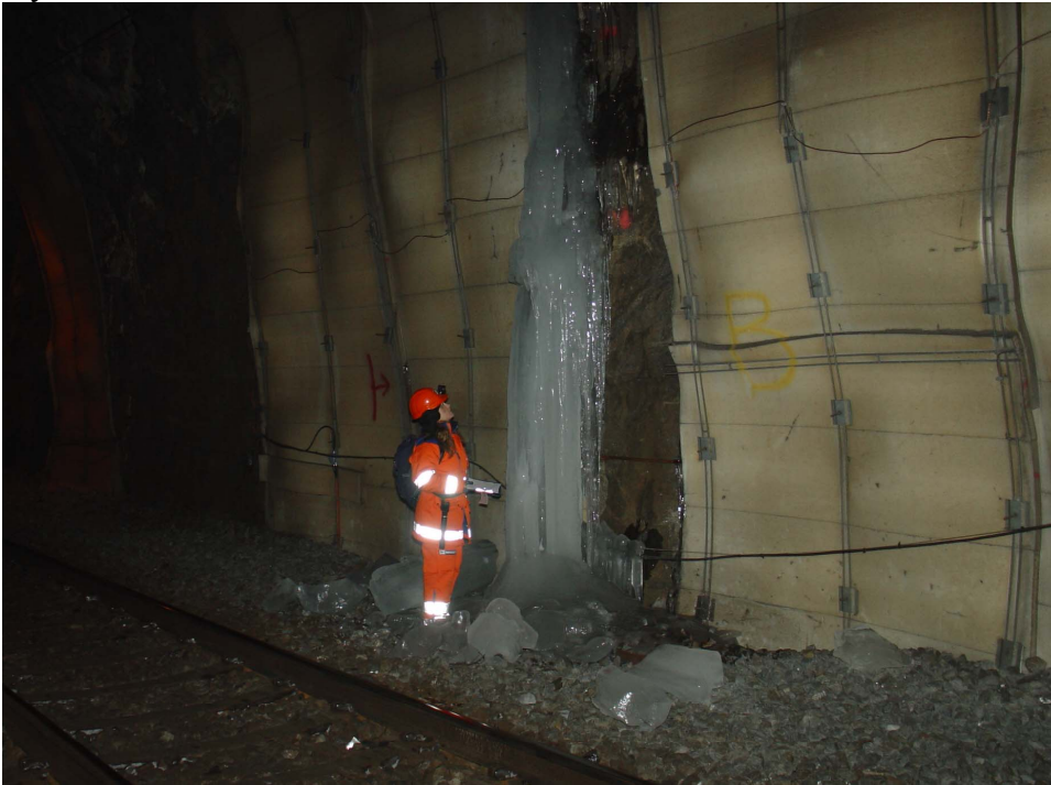
Figur 1-1 Isbildning vid sidan om PE-skum-matta i en järnvägstunnel.
