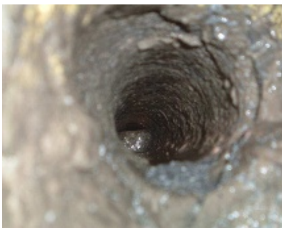
Figur 1 Efter att manchetten tagits ut syns en luftspalt ovan bruket i det fuktiga injekteringshålet.
