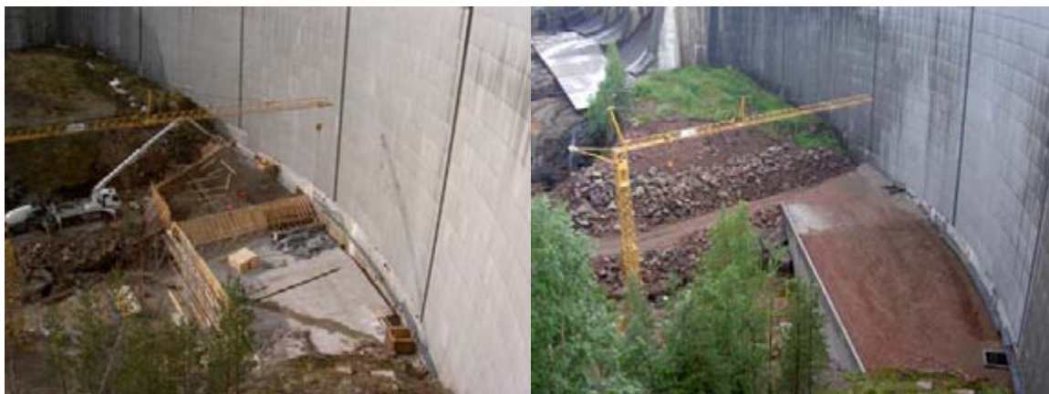
Bild 2 och 3. Den vänstra bilden togs i samband med gjutningen och den högra är tagen efter plattans färdigställande. The left picture was taken in connection with the casting and the right picture after the completion of the slab.
