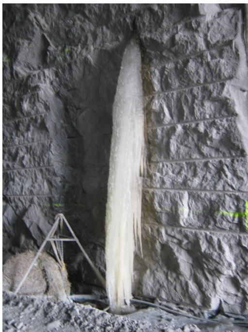
Fig. 3. Isbildning vid läckande borrhål för systembult. Ice formation from a leaking bolthole.
