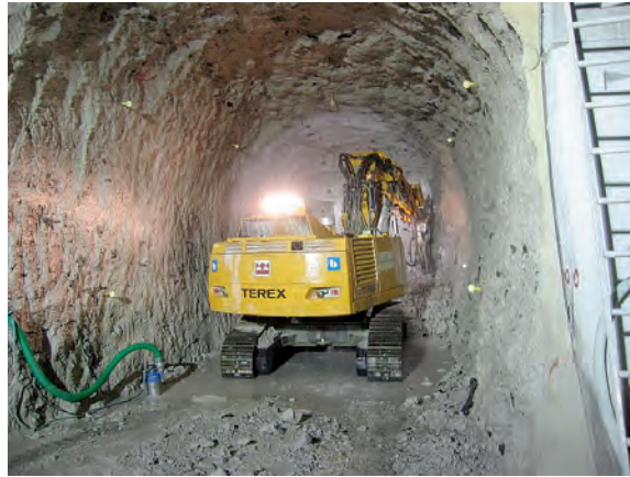
Figur 4.4 Drivning av tvärtunnel m.h.a. hydralhammare, i tak och väggar syns prismor för konvergeringsmätningar ( Excavation of cross passage, in the roof and walls prisms used for convergence readings can be seen )
