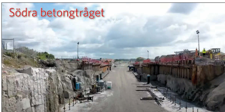
Figur 5.6 Varbergstunneln, södra tunnelpåslaget. Bild tagen strax utanför tunnelmynningen vid schakt för betongtråg.
