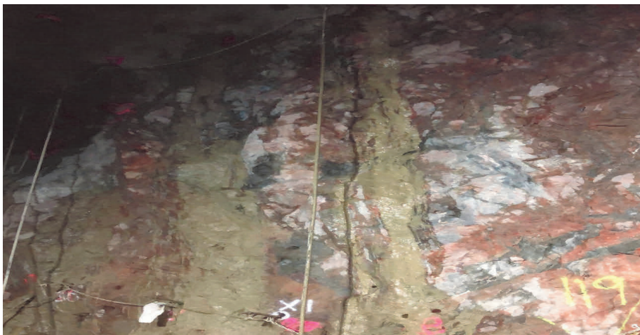
Figur 10.14. Läckage vid vänster sida av stuff, sektion 119/325.
