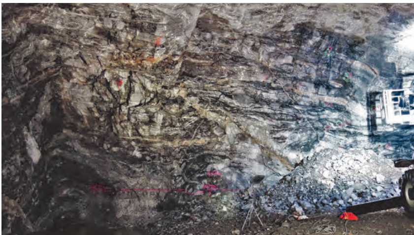
Figur 5.2. Svag bergstruktur på vägg, sektioner 223545–556.
