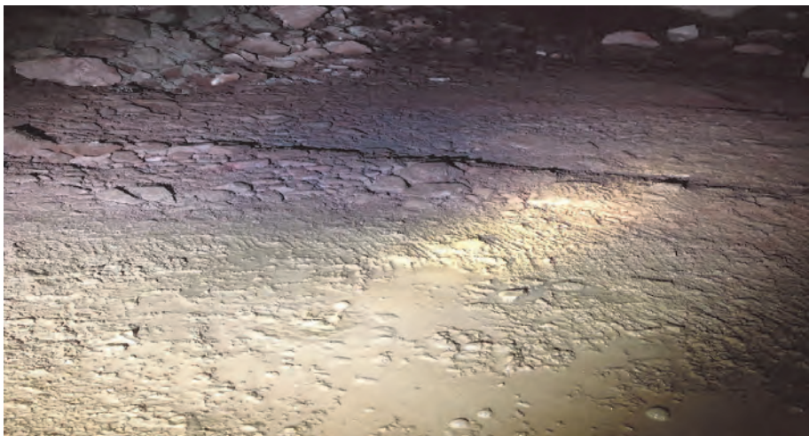
Figur 10.12. Ytläckage i vänster sida av vägbanan, sektion ca. 119/260. Figure 10.12. Surface leakage in the left side of the road, section approx. 119/260.
