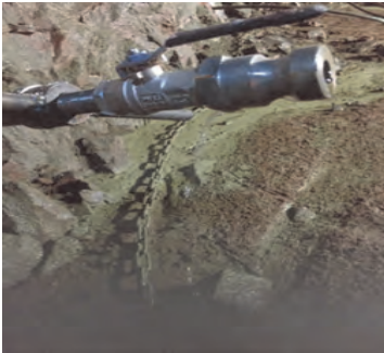
Figur 10.6. Skydd av nedåtriktat hål. Figure 10.6. Downward hole protection.
