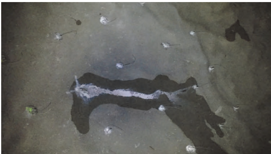
Figur 10.13. Utläckage av injekteringsbruk i bulthål, Sektion 119/280, vänster tak. Figure 10.13. Leakage of grout in bolt holes, Section 119/280, left roof.
