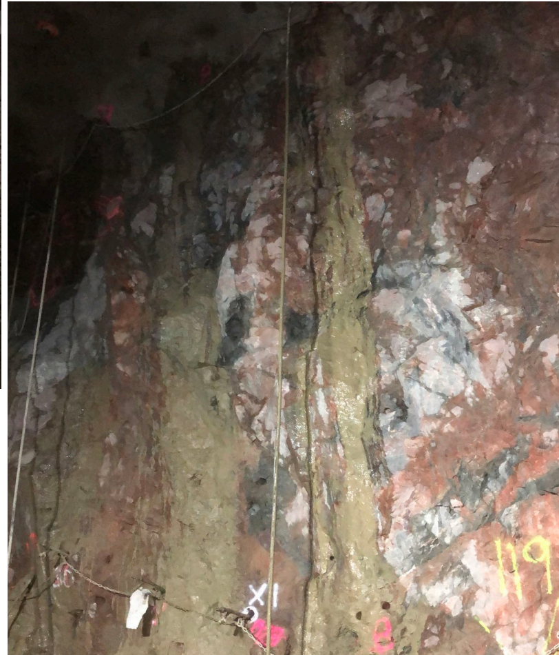
Utläckage av injekteringsbruk i stuff, Sektion 119/325
