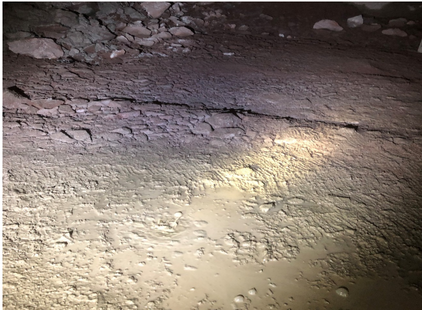
Utläckage av injekteringsbruk i vägbana, Sektion ca.119/260 (ca 30m från stuff)
