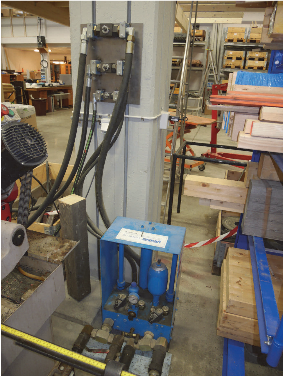
Figur 5. En uttagsstation till hydraulpumpen. Levererar 220 bar och 90 l/min. Manifold system for the outlet from the hydraulic pump.
