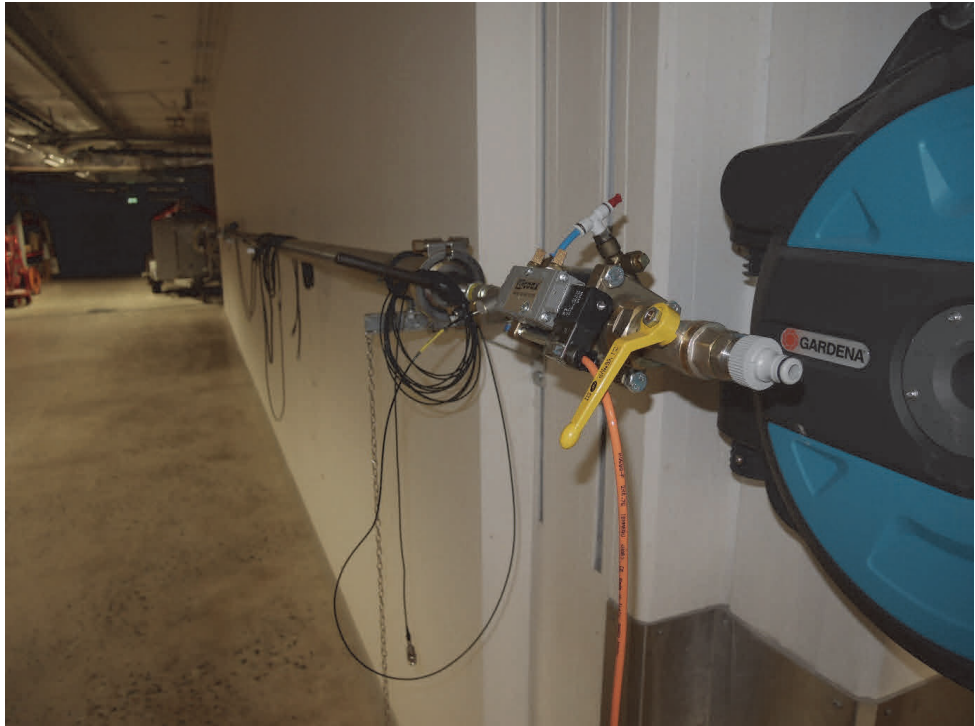
Figur 99. Närmast i bild den elektriskt styrda, tryckluftassisterade koaxialventilen som snabbt kan avbryta flödet i injekteringsröret och den 12 m långa borrhålssimulatorn. Electrically controlled coaxial valve mounted in the borehole simulator.
