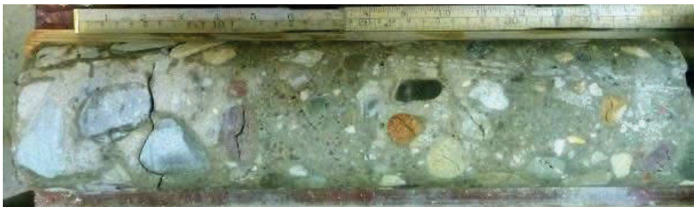
Figur 3.24 Betongprov taget från konstruktionen. Ballastkorn är spruckna p.g.a. ASR.
