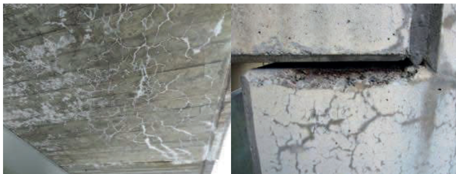
Figur 1.13 Vänster: Sprickmönster på undersida brobalk med vita kalkutfällningar. Höger: Kombination mellan ASR och frost på stöd.
