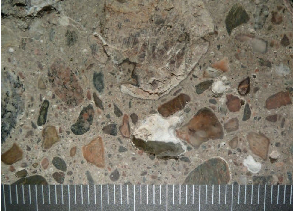
Figur 5. Slipad betongyta, lämplig att användas för DRI. I bilden kan man se sprickor i ballast och cementpasta fyllda med vit alkalisilikagel.
