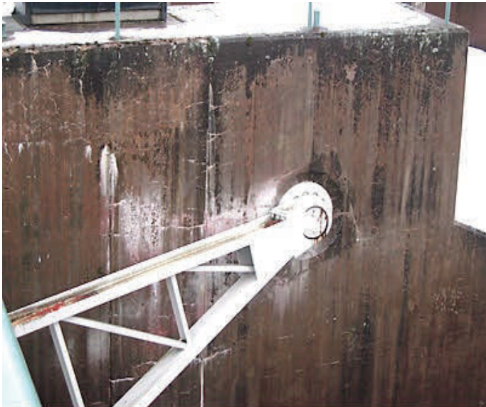
Figur 1.15 Regleringsdamm, Dalarna, från 1956 med sprickor kring dammluckans fäste. Finkorniga metasedimentära bergarter var ett betydande inslag i ballastmaterialet.
