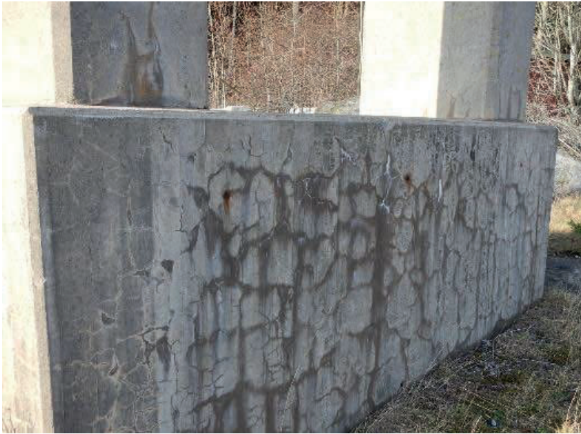
Figur 3.31 Krackeleringsmönster på pelarstöd.
