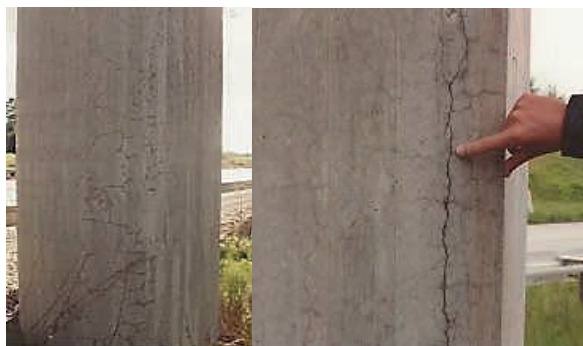
Figur 1.12 Karaktäristiskt sprickmönster på bropelare (vänster). Vid kraftigare expansion bildas sprickor längs armeringen (höger).
