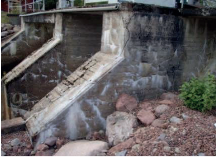
Figur 1.14 Regleringsdamm, Dalarna, från 1953. Kraftig sprickbildning med kalutfällningar som orsakats av ballastmaterial bestående av höga halter av röd kvartsporfyr (se bildens förgrund).
