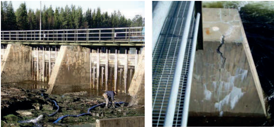
Figur 3.25 a) Översikt utskovsdamm. b) Sprickor i utskovspelare.
