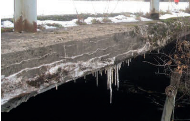
Figur 3.32 Brobana över kraftstation, med kraftig sprickbildning orsakad av en kombination av ASR och frost.
