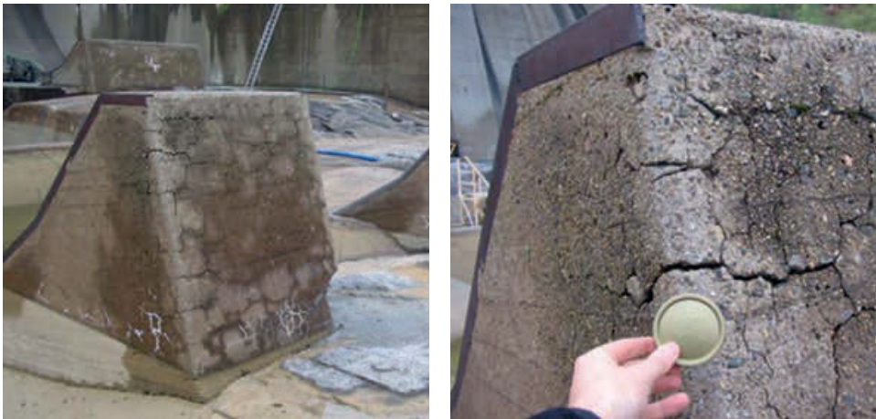
Figur 3.26 a) Översikt av spruckna strålklyvare. b) Detalj från sprickbildning i strålklyvare.
