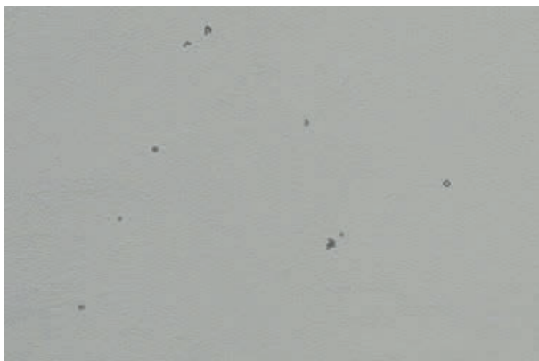
Figur 3.3 Betongfasad med små utspjälkningar, "pop-outs".
