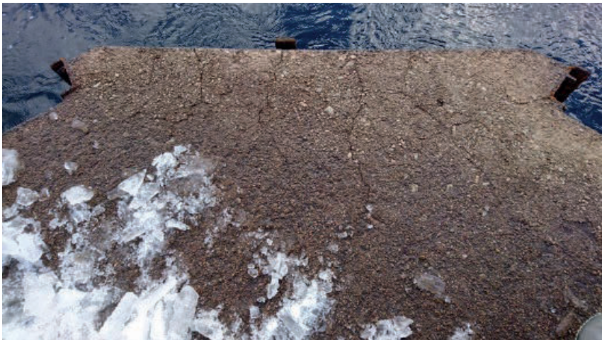
Figur 3.19 ASR-skadad betong i en vattenkraftanläggnings utskovstorn.
