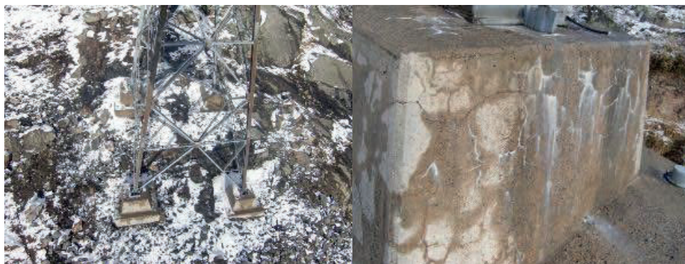
Figur 1.16 Stolpfundament som uppfördes 1975 i fjällkedjan med tydliga ASR-sprickor. Högalkaliskt cement i kombination med metasedimentära bergarter var orsaken till sprickbildningen.
