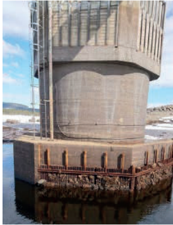
Figur 3.18 Utskovstorn i en vattenkraftanläggning.
