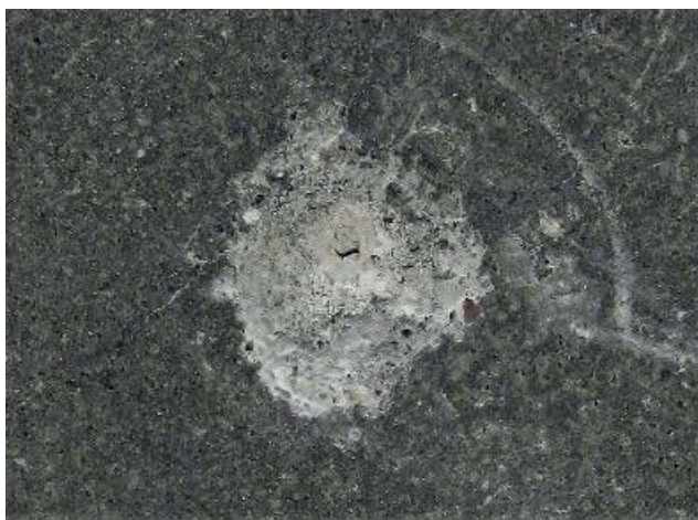
Figur 3.4 Utspjälkningar ("pop-outs") orsakade av ASR i golv.
