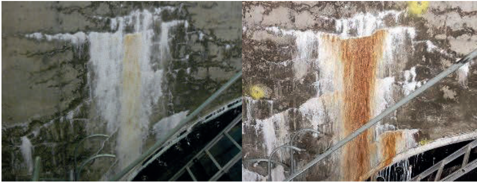
Figur 3.22 Sprickbildning med utfällningar. Utveckling från 2011 till 2018.
