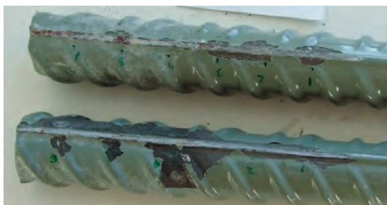
Figur 10. Epoxybeläggning med dålig vidhäftning vid blottlagd yta
