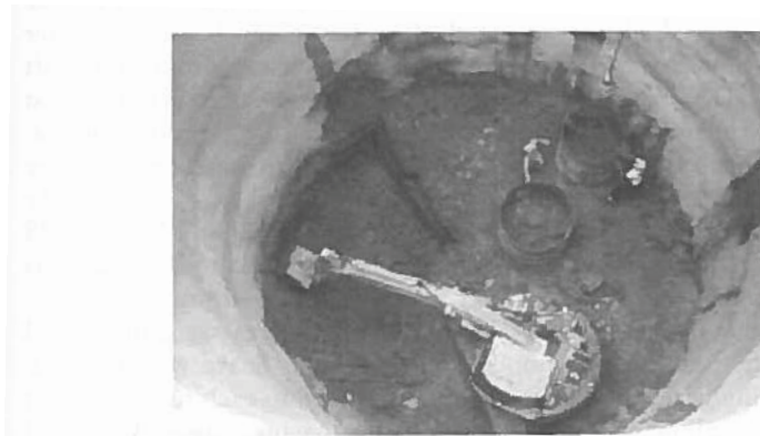
Figur 9 Byggande av schakt (bild från Kirsch och Bell, 2013). Shaft excavation in progress.
