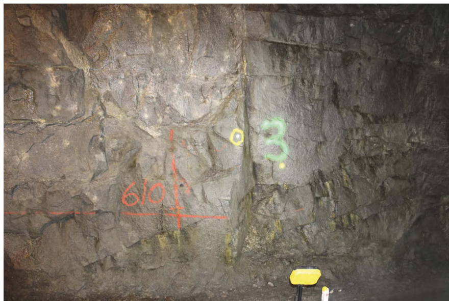
Figur 2: Spricka 3. Sprickan går över hela tunneln.
