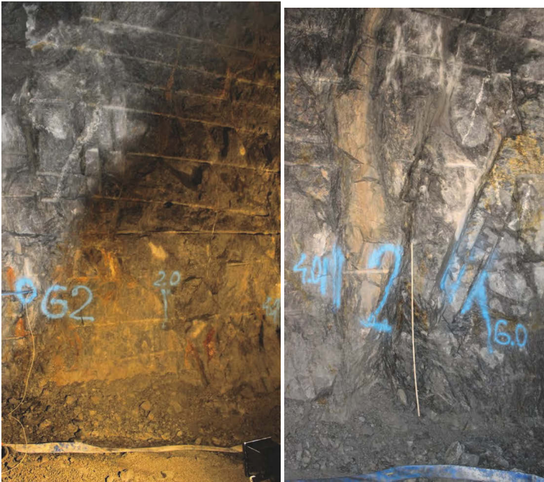
Figur 11: Borrhål G2 (bild till vänster). Spricka 2 och några sprickor till i tunnelväggen ca. 5 m från borrhålmyningen (bild till höger).
