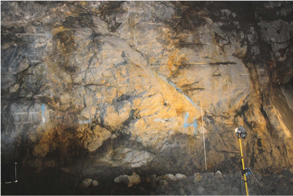
Figur 15: En spricka i tunnelväggen markerad som nr. 4. Flera sprickor syns i tunnelväggen.
