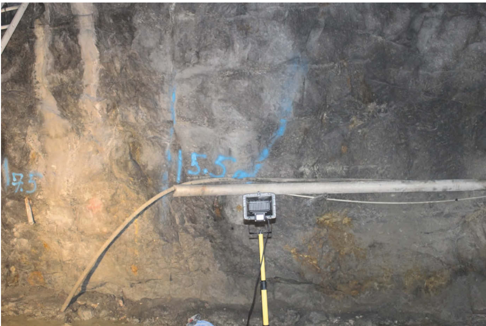
Figur 5: Sprickor i tunnelvägg cirka 5.5 m från korsningen.
