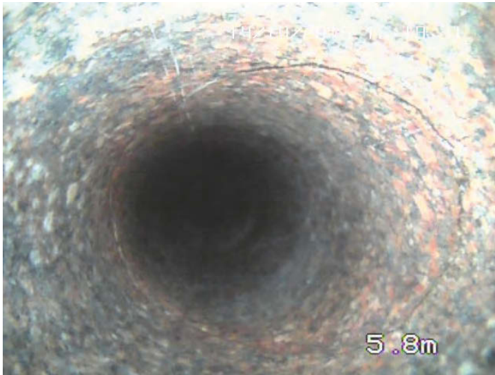
Figur 4: En bild av sprickan i BH3 sektion 4. Bild från borrhålkamera.
