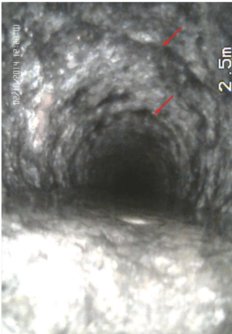
Figur 19. Observerade sprickor i BH G3 2.5 m från borrhålmyningen. Vatten på botten i borrhålet.
