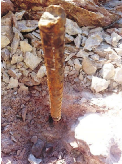
Figur 4-3 Exempel på låg grad av yttlig korrosion på en 50 år gammal bergbult. Från (Ljungberg 2016).
