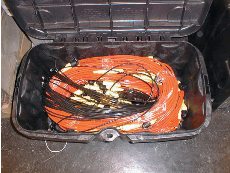
Figur 10. Kabelstam (orange) och pigtails (svart). Cable stem and pigtails.
