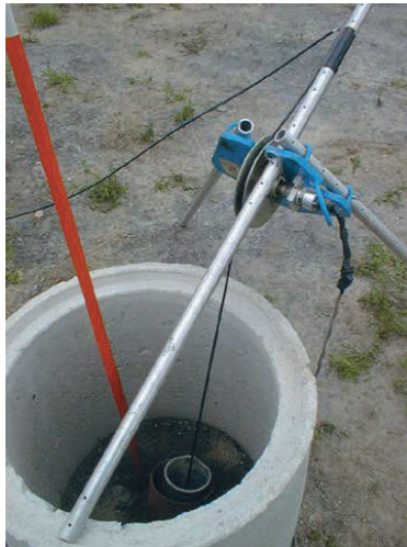
Figur 26. Simulatorens nedsänkning till botten i det 80 m djupa borrhålet som är försett med foderrör av plast (utom allra längst upp där det sitter ett kort yttre skydds rör av stål utanför plaströret) och filter i de djupaste metrarna. Foderröret av plast gör att inga signaler smyger upp till ytan längs röret, vilket skulle ske med foderrör av stål. Filtret gör att det elektriska fältet som simulatorens alstrar tränger ut i formationen. Måthjulet håller ordning på vid vilket djup simulatorens befinner sig.
