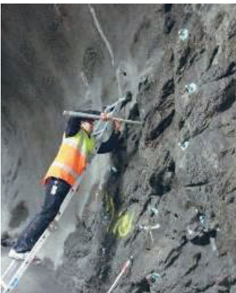
Figur 4 Montering av provkroppar i förborrade hål i Muskötunneln (Mounting of rock bolts in drilled holes in the Muskö tunnel).
