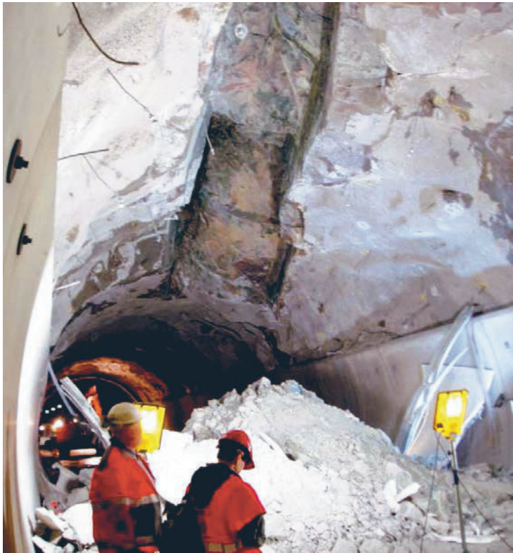
Figur 13. Ras vid Hanekleivtunneln, Norge
