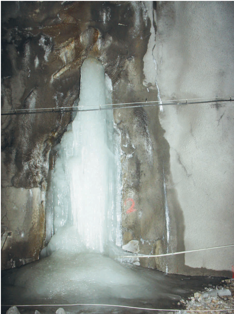
Figur 8. Läckage vid sidan av drän, isen belastar handledare som brutits sönder. (Foto: A. Andréén).
