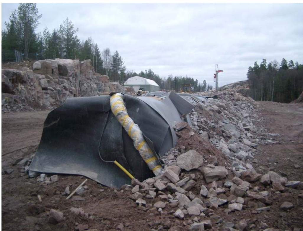
Figur 4.3 Reningsanläggning vid Norrortsleden i Sollentuna. Anläggningen är avsedd för avskiljning av slam och olja. Viss rening har redan skett i container (se bild figur 4.2 ovan). Observera isolering och skydd mot påkörning. (foto Johan Ekvall)
