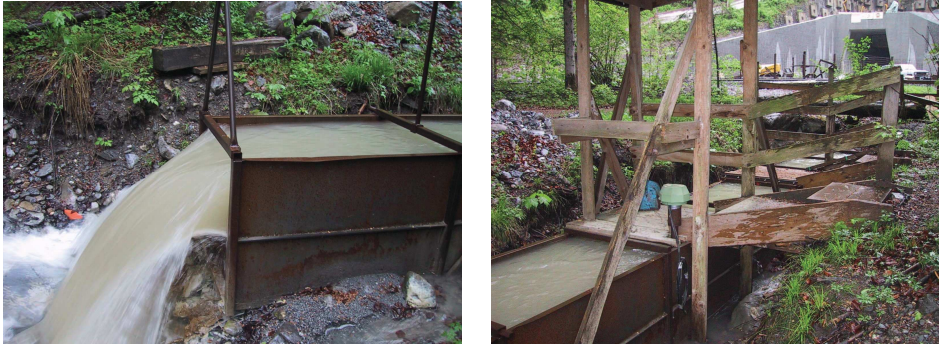
Figur 3-1. Rektangulärt överfall installerat vid Engelbergstunnelns norra tunnelmynning.
